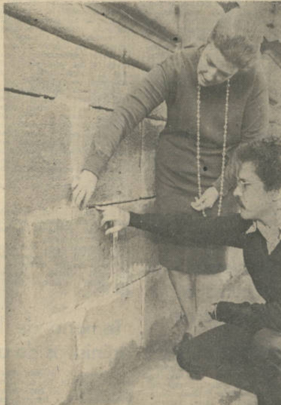
SE DAÑA TEATRO NACIONAL. Debido a la utilización de arenas marinas en la mezcla adhesiva, las estructuras de piedra del coliseo sufren hoy serios daños. Doña Graciela Moreno y don David Vargas, muestran el proceso de restauración que se está aplicando para evitar mayores desgastes. — (Aguilar).
